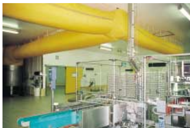
Photo 2 - Conditionneur d'air à soufflage direct par réseau de gaines textiles : - implantation du conditionneur au sol, - soufflage d'air basse vitesse. "Compagnie des Fromages, Ducey (50)"
